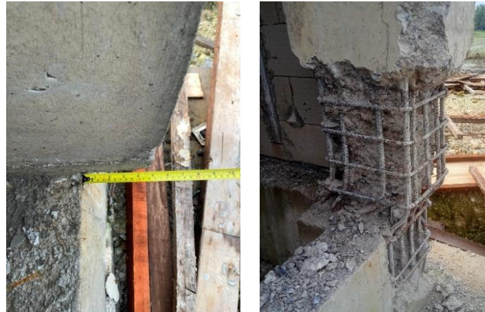
Gambar 1. (a) Kondisi Pergeseran Kolom; (b) Kondisi Aktual Kolom yang Bermasalah
